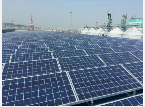
인천 KCTC 물류센터 태양광발전설비
