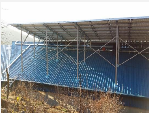
하동 야베스 다운 태양광발전소
