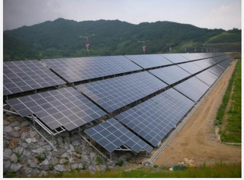
예천양수발전소 2MW 태양광설비
