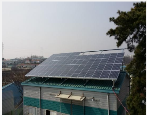
일산 공장지붕 태양광발전설비
