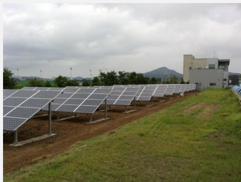
태안군 상수도사업소 태양광발전설비
