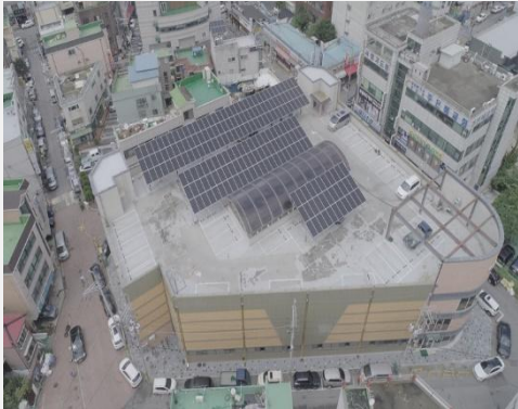
관양2동 공영주차장 태양광발전설비
