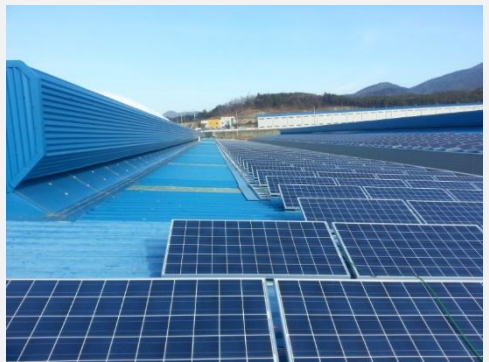
고려제강 1.45MW 태양광발전설비
