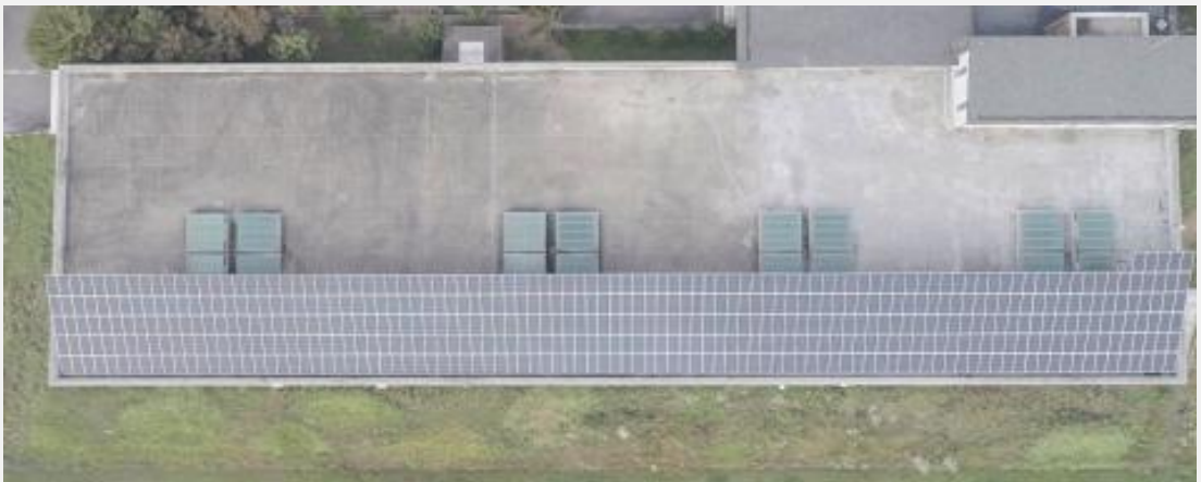
오산시 세마 하수처리장 태양광발전설비
