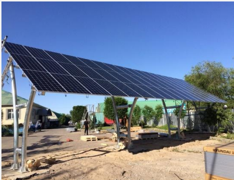
카자흐스탄 주차장 태양광발전설비
