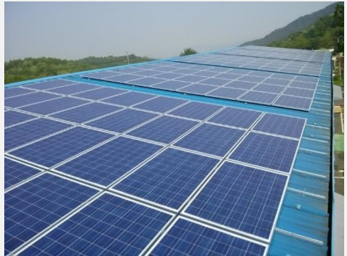
안성 CFA 공장지붕 태양광발전설비
