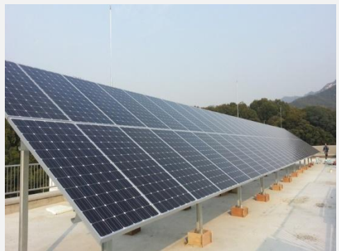
5181 부대 관사 태양광발전설비
